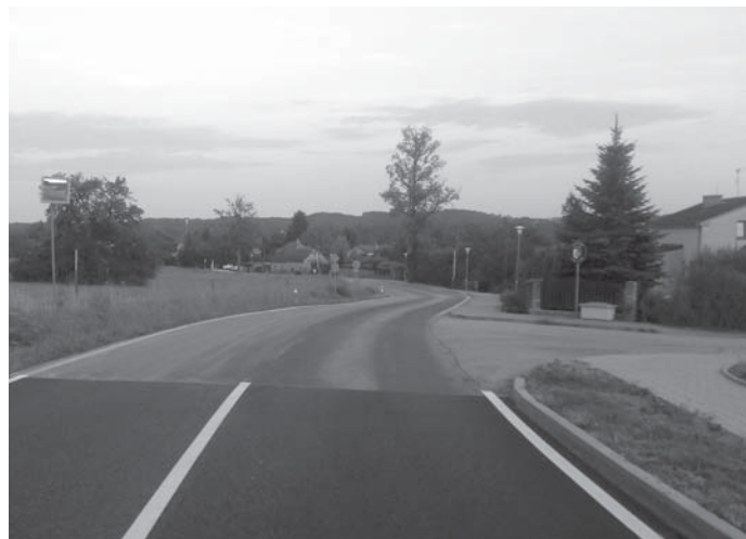
Současný stav hlavní silnice směrem od Nedabytle, kde skončily opravy v loňském roce.
